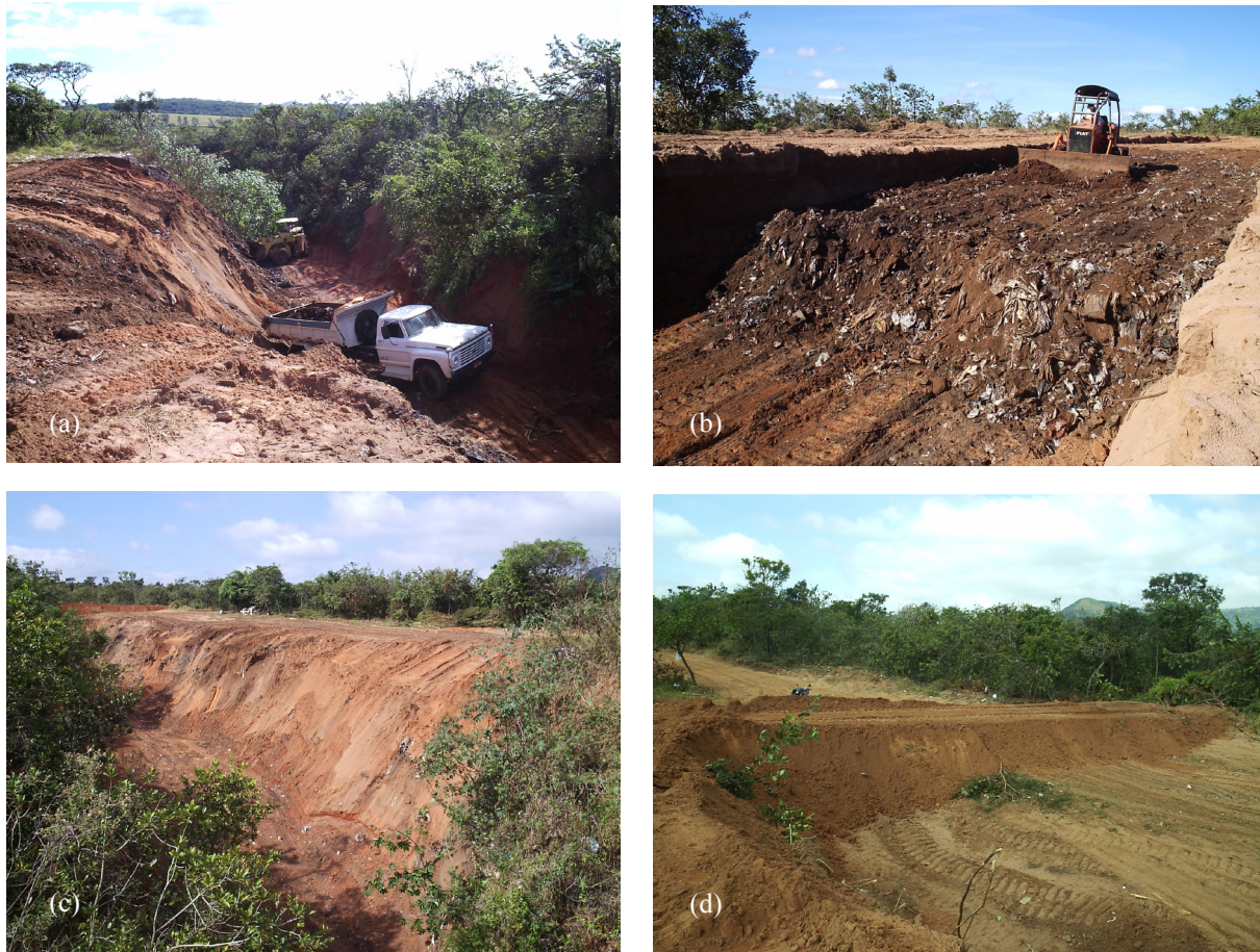
FIGURAS 4: (a) Retirada dos resíduos da voçoroca; (b) Compactação dos resíduos na vala; (c) Vista da área com terraço ao fundo; (d) Terraço para desvio de enxurrada.
