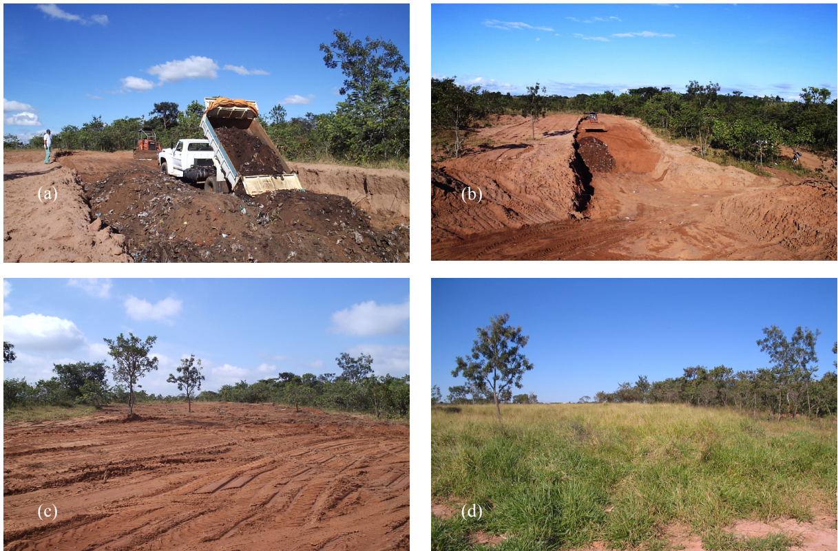
FIGURA 5: (a) Preenchimento da trincheira com resíduo misturado ao solo; (b) Armazenamento de resíduos com cobertura de solo; (c) Encerramento da trincheira com solo composto de matéria orgânica; (d) Área da trincheira completamente revegetada.
