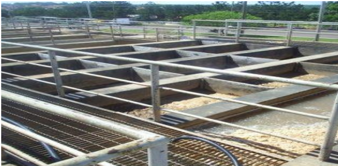
Figura 5. Etapas de Tratamento ETA II – Decantadores.
