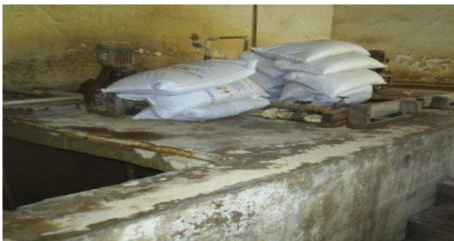
Figura 3. Etapas de Tratamento ETA II – Coagulante – Sulfato de Alumínio.
