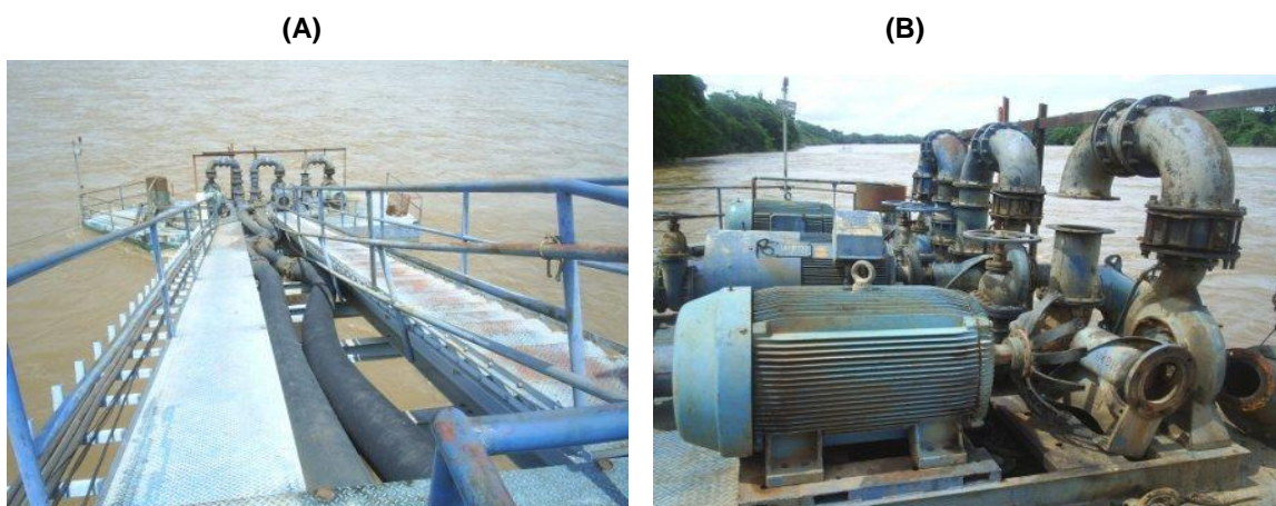
Figura 2. Plataforma de captação de água da ETA II (A) e Sistema de bombeamento e tubulações de captação de Água ETA II (B).
