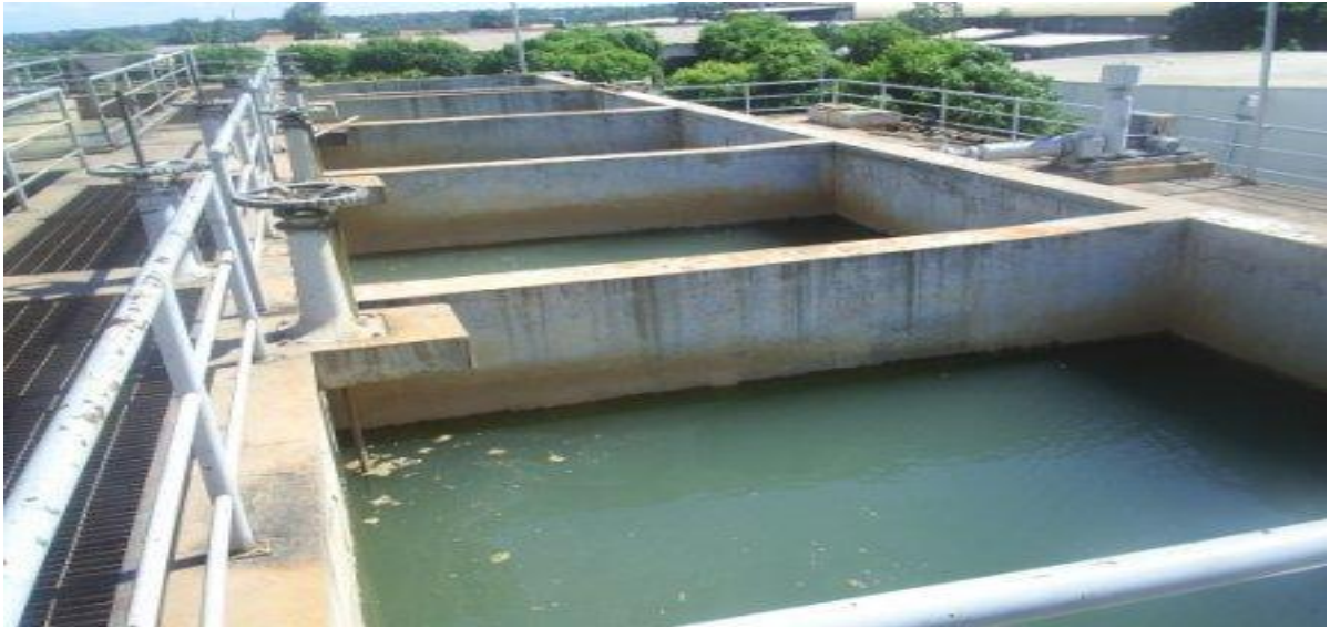
Figura 6. Etapas de Tratamento ETA II – Filtros.
