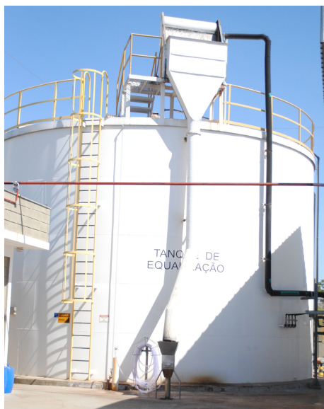
Figura 4. Tanque de Equalização/Hidrólise ( Fonte: RAMOS, 2011).
