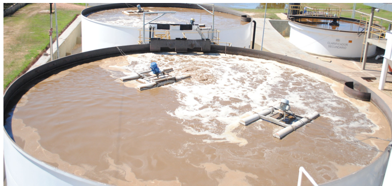
Figura 6. Tanque de lodo ativado ( Fonte: RAMOS, 2011).
