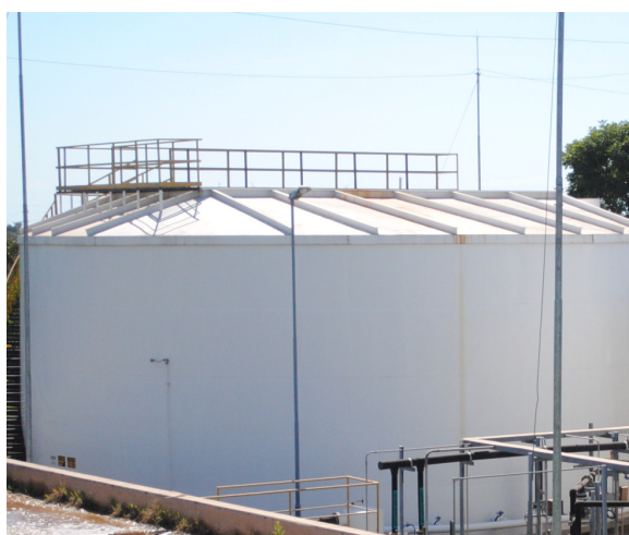
Figura 5. Reator Anaeróbico de Fluxo Ascendente – RAFA ( Fonte: RAMOS, 2011).
