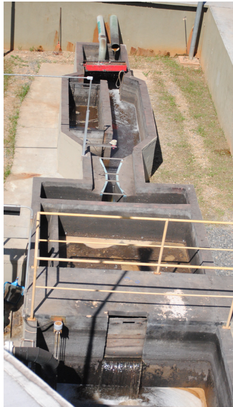
Figura 3. Tratamento Preliminar do Efluente ( Fonte: RAMOS, 2011)
