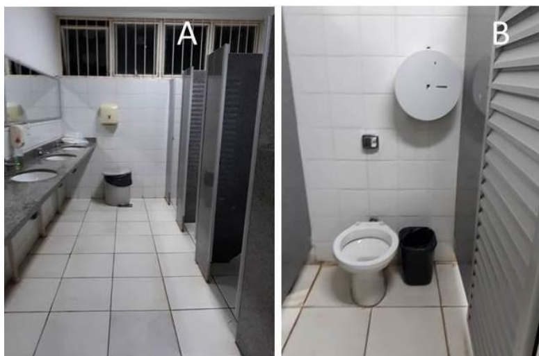
Figura 6: coletores dos banheiros nas imagens A e B. Coletores sem identificação, foto tirada do IFMT Bela Vista.
