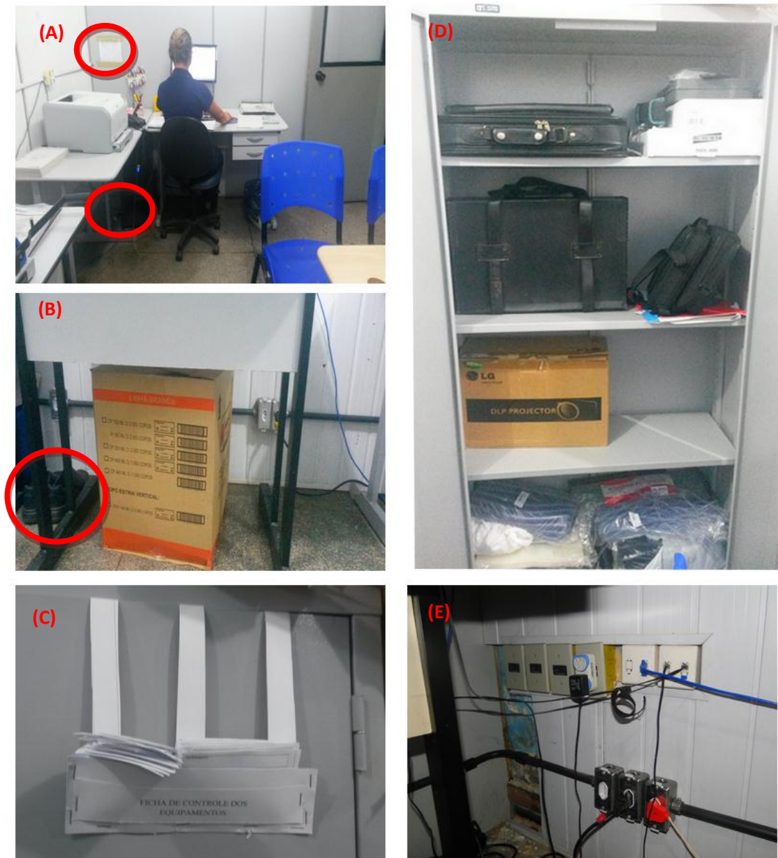
Figura 4. Setor de Qualidade. As fiações elétricas da empresa estão expostas, gerando riscos de choques (A) e (E); Esboço de ramais na parede, contribuindo para uma poluição visual (A); Equipamento de Proteção Individual em local inadequado, caixa de papelão sem uso (B); Fichas para controle de uso de equipamentos (C); Organização interna do armário do setor (D).
