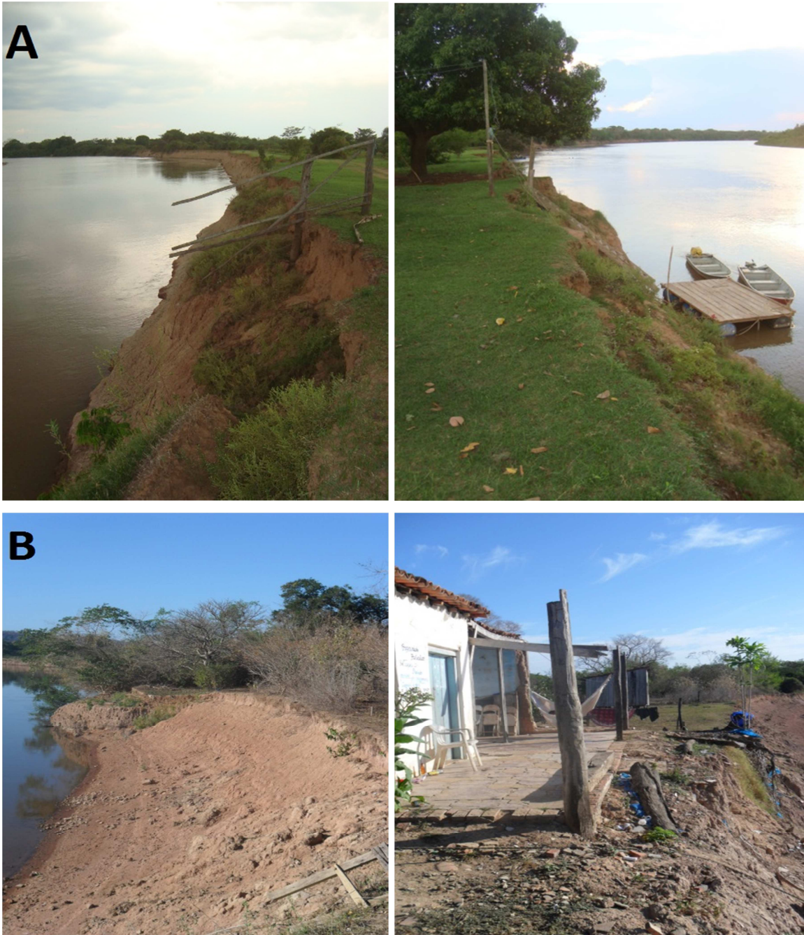
Figura 10: Erosão e instabilidade das margens do rio nas propriedades: A-P2 e B-P4, no município de Barão de Melgaço-MT.
