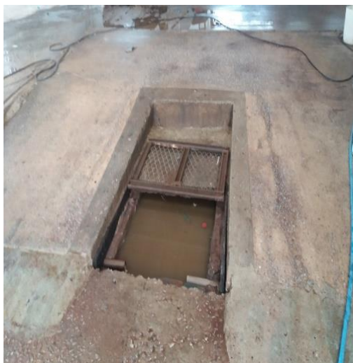
Figura 5 – Caixa de Areia (Fonte: Autor próprio;2017).
