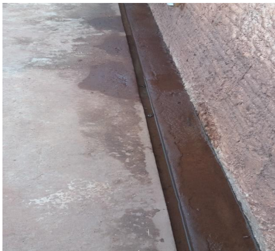
Figura 17 – Canaletas (Fonte: Autor próprio;2017)
